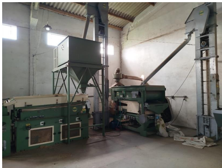
Figura 8 - Máquinas de ar e peneiras utilizadas na UBS da Rede BioNatur
