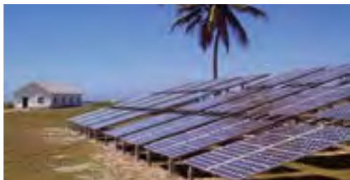
Fig. 6. Instalación FV en el fuerte Jefferson de los EE.UU.
