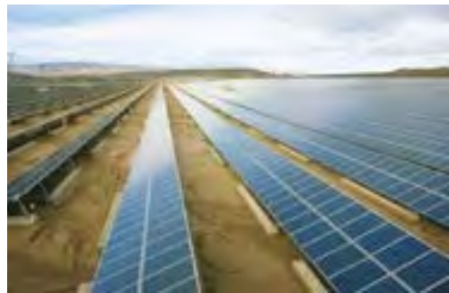
Fig. 1. SFV similares pero con anclajes al suelo distintos.
