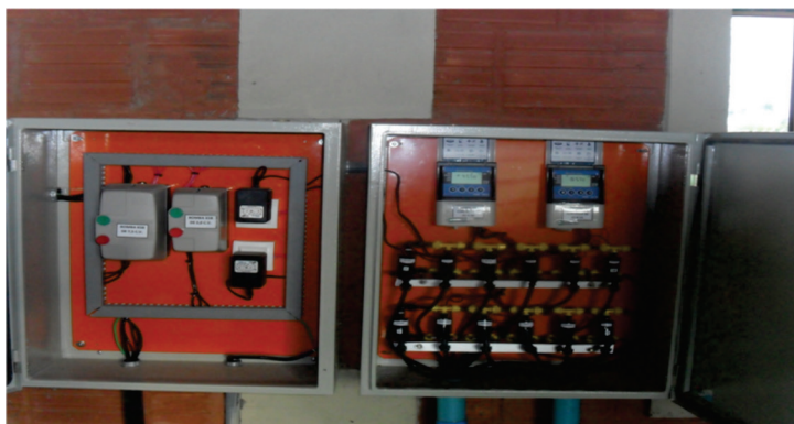
Figura 13 – A esquerda, controle eletrônico, e a direita, controle hidráulico do sistema de irrigação, UNEB/DTCS/Caerdes, Juazeiro-BA, 2014
