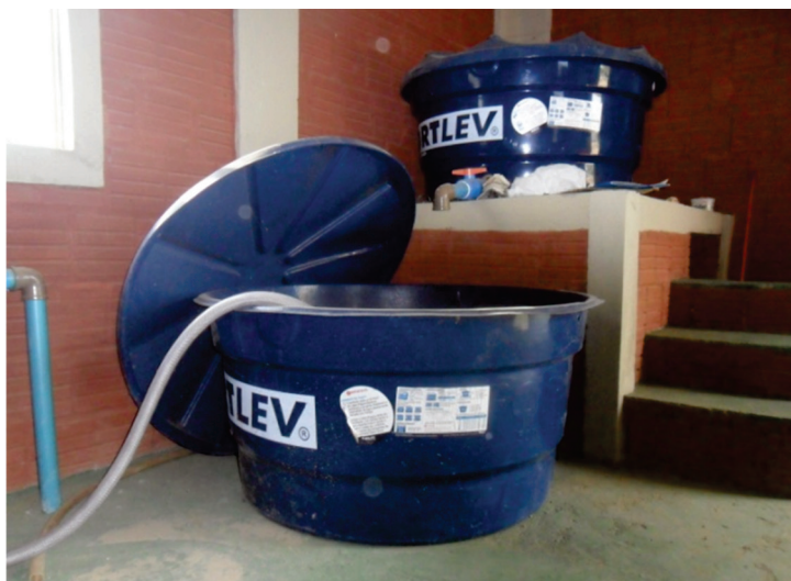
Figura 12 – Tanque de fertirrigação, UNEB/DTCS/CAERDES, Juazeiro-BA, 2014
