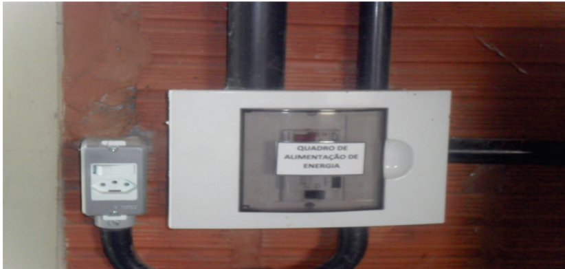
Figura 14 – Quadro de alimentação de energia do cabeçal de controle com disjuntor de sobrecarga de energia, UNEB/DTCS/Caerdes, Juazeiro-BA, 2014
