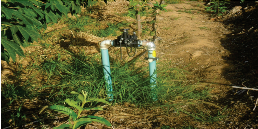
Figura 18 – Válvulas e início da linha lateral, UNEB/DTCS/Caerdes, Juazeiro-BA, 2014
