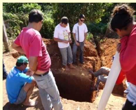
Fossa Biodigestora Propriedade Vera e João ,Paula Cândido
